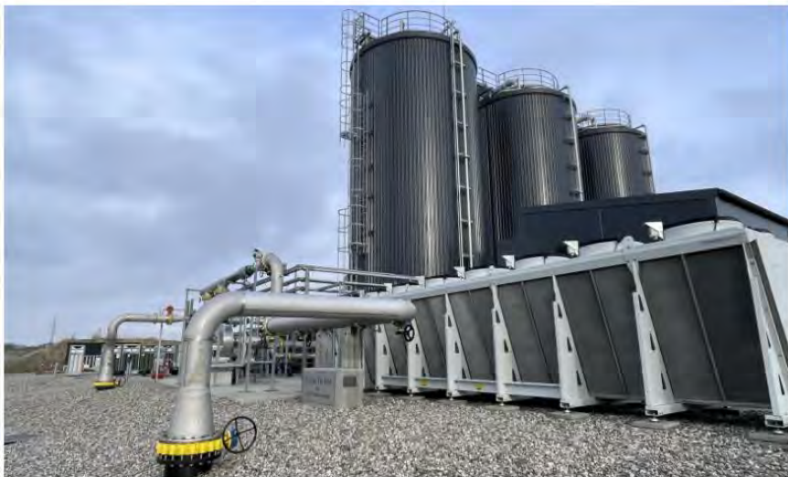
Selve metaniseringsprocessen foregår i de tre høje siloer. Forrest ses det rør, der leder den færdige biogas væk fra anlægget
